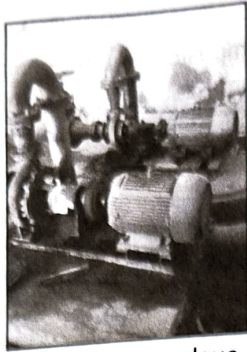
bombas de recalque
