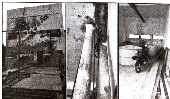
estrutura da ETA em estado precário
