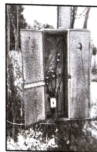
painel de entrada de energia da ETA
